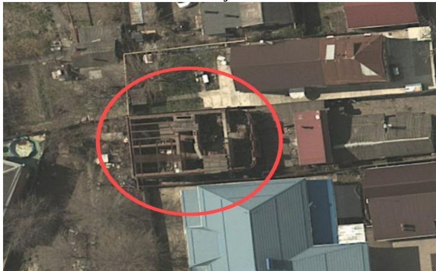
Рисунок 3. Пример полуразрушенного участка крыши
